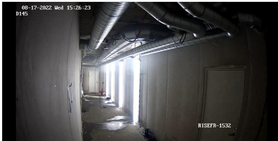
(a) Ved første eksplosjonsaktig ventilering i batteriet.
