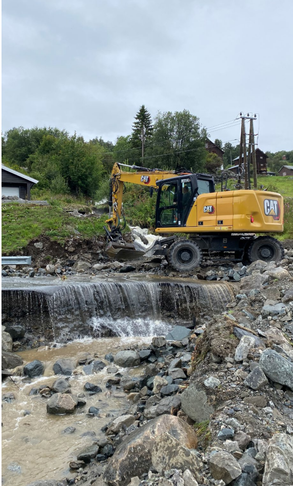
Lokale entreprenører i gang med oppryddingsarbeid i en av de mange bekkefarene som fikk stor vannføring og der stein og grus ødela veiforbindelser til flere boligområder. Fra Ål kommune. Foto: Ål kommune
