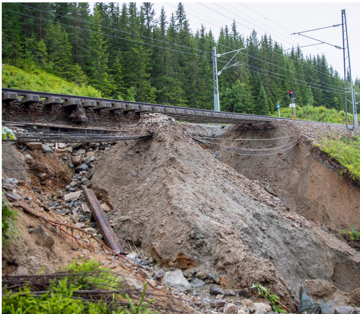
Deler av Bergensbanen har rast ut i terrenget ved Hagafoss under ekstremværet Hans. Foto: Frederik Ringnes / NTB
