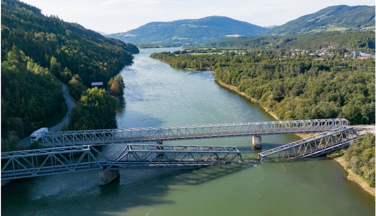
Jernbanebrua Randklev bru over Gudbrandsdalslågen i Ringebu brøt sammen i kjølvannet av ekstremværet Hans og flommen i Lågen. Foto: Geir Olsen / NTB
