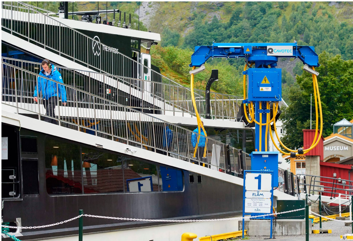
Fjernstyrt landstrømstilkobling. Foto: CAVOTEC.
