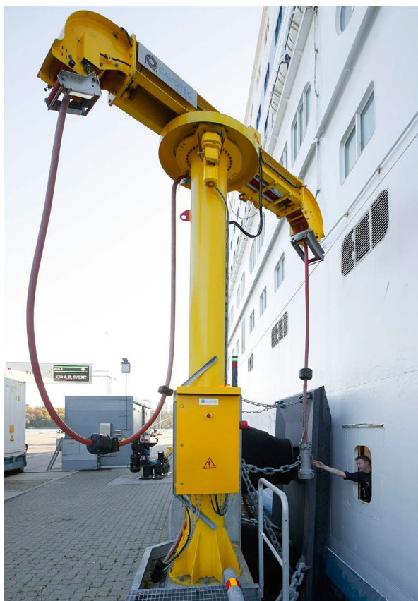
Fjernstyrt landstrømstilkobling. Foto: Cavotec
